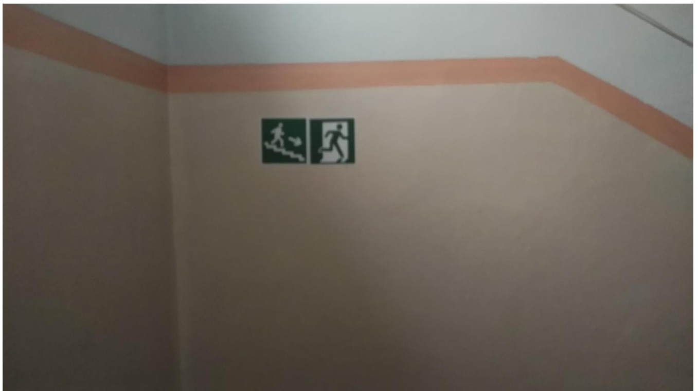
Фото №30 – информационные знаки на путях эвакуации
